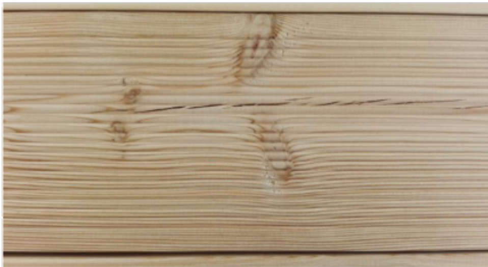
Fot. 3 - pęknięcie włosowate
