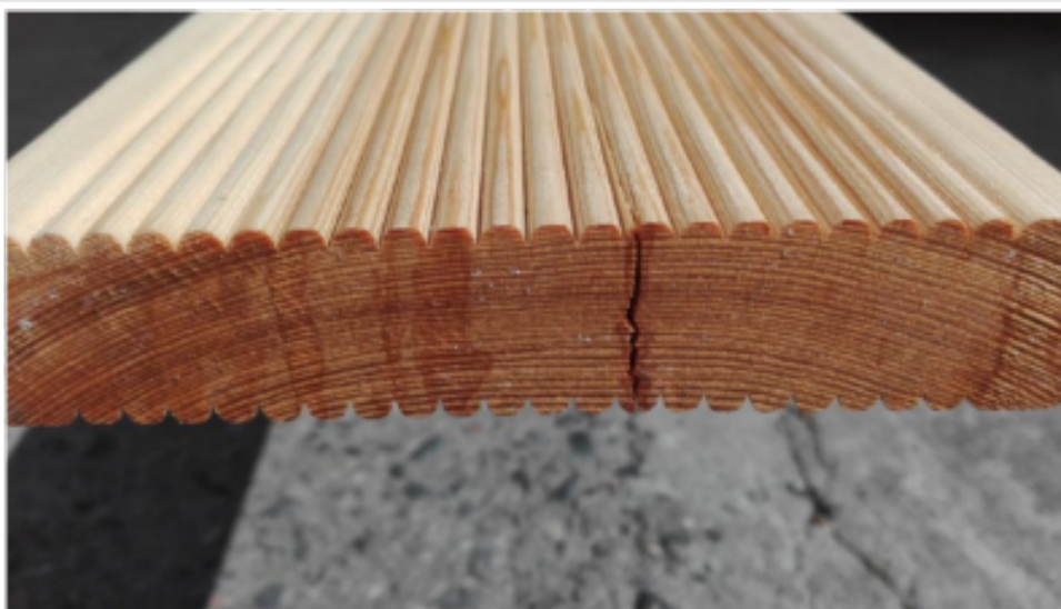
Fot. 18 - pęknięcie przechodzące czołowe
